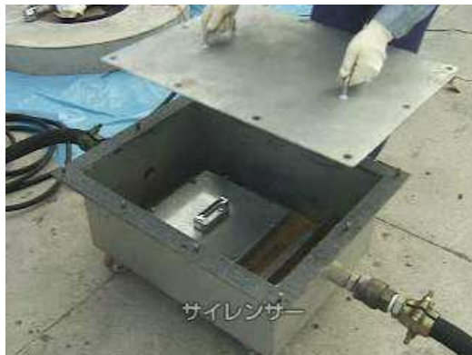
写真 4-1 サイレンサー内の設置状況
